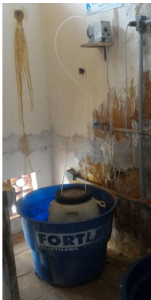
Foto 3.4 – Bomba dosadora de flúor
