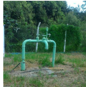
Foto 3.2 – Poço Subterrâneo - SABESP
