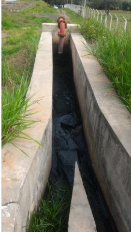
Foto 3.15 – Tratamento preliminar – Caixa de areia
