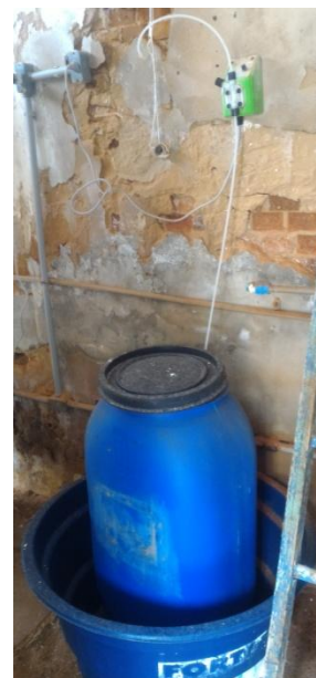
Foto 3.5 – Bomba dosadora de cloro
