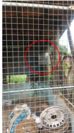
Foto 3.10 – Painel automático da bomba submersa
