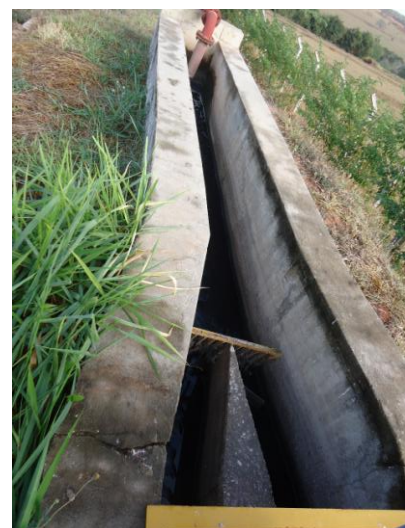
Foto 3.14 – Tratamento preliminar – Gradeamento
